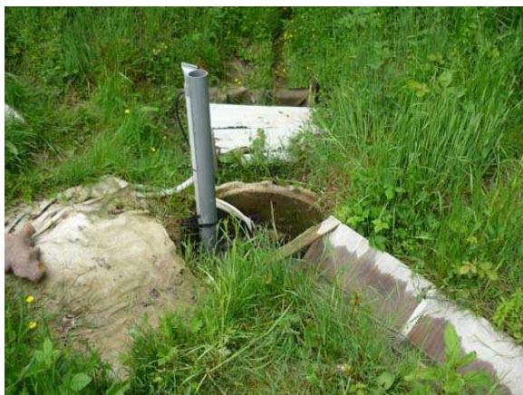
Fossé de reprise et débitmètre à l'aval de la lagune
