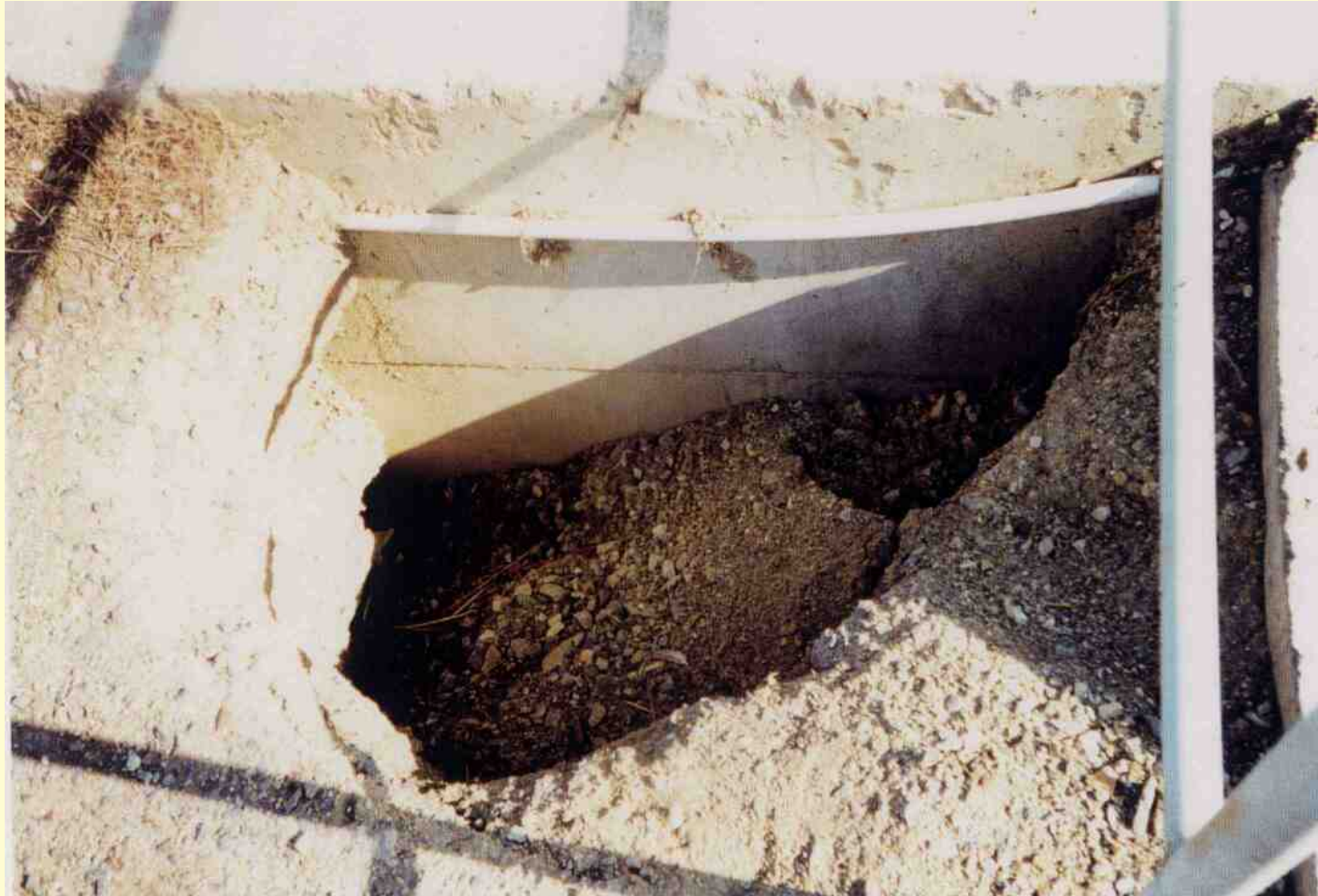
Fontis dans remblai de l'ouvrage
