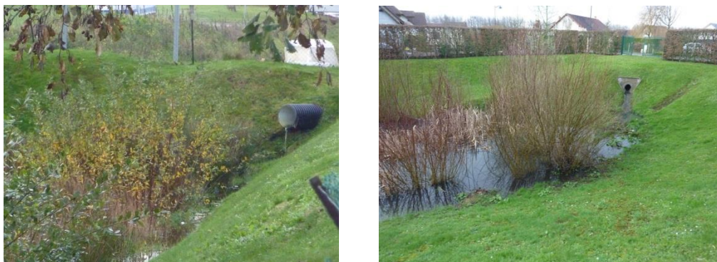
Figure 10 : bassins alimentés par un réseau de canalisations enterrées
