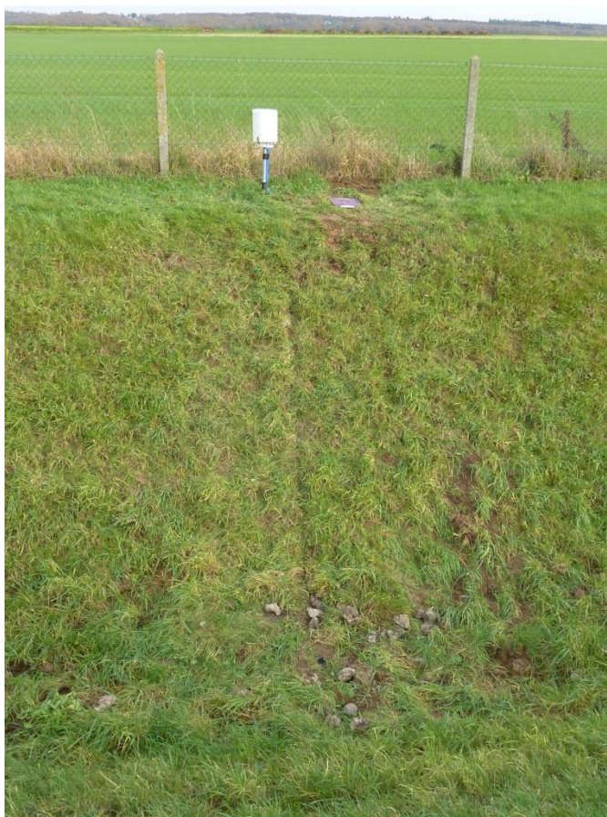
Figure 29 : Instrumentation d'un bassin d'infiltration : pluviomètre, enregistreur (dans le regard) et sonde piézométrique dans le fond du bassin pour mesurer le niveau d'eau (bassin d'Ymare)
