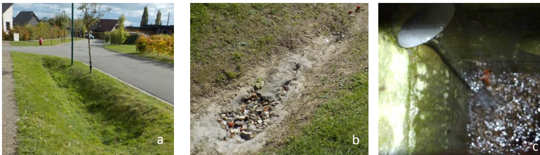
Figure 6 : a) Noue drainée – b) Massif drainant affleurant sous géotextile déchiré – c) rejet des eaux issues des massifs drainants dans un regard en aval
