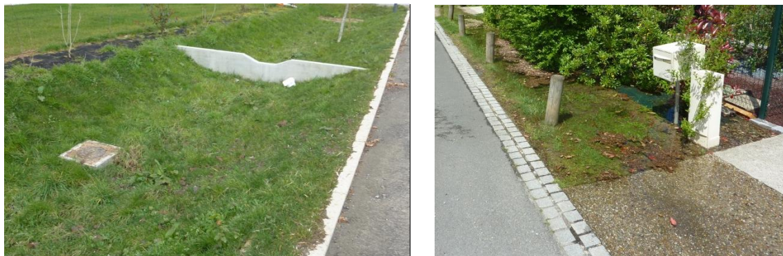
Figure 57 : regard de branchement d'eaux usées dans une noue (à gauche), coffret électrique dans l'emprise de la zone immergée lors de la surverse d'une noue (à droite)
