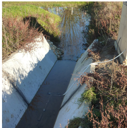
Canal de mesure en entrée
