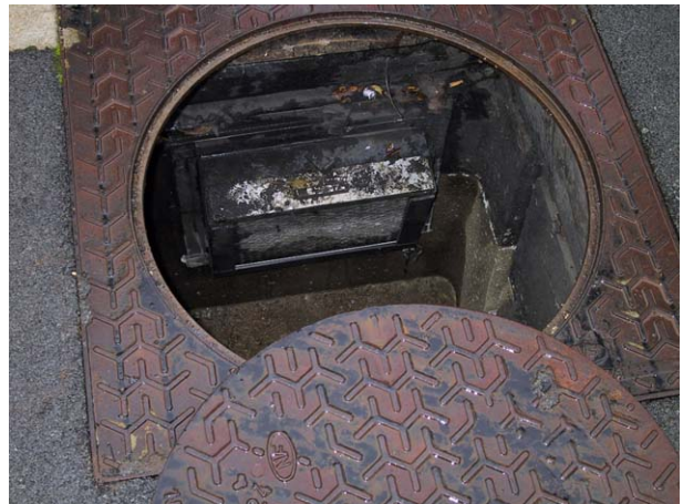
Bouche d'injection avec filtre
