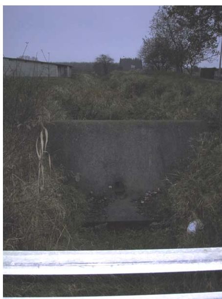
Ajutage dans le fossé pour réduire le débit
